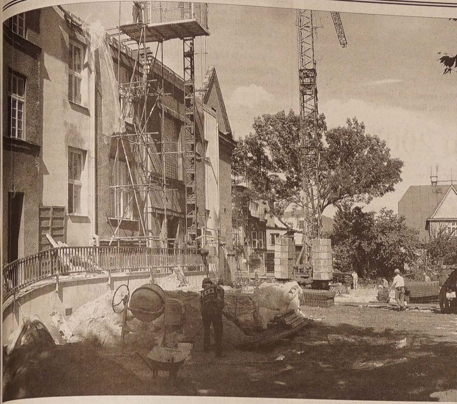
Prace jablonkowskiej polskiej podstawówki przy ul. Szkolnej przekształciło się w plac budowy.
