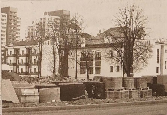
Prace budowlane przy drodze dojazdowej do autostrady D 47 są przeprowadzane tuż obok „Domu Polskiego” oraz gruntów LSPD.
