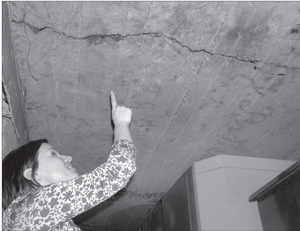
Katarzyna Klimoszek pokazuje szkody górnicze w swoim domu.
