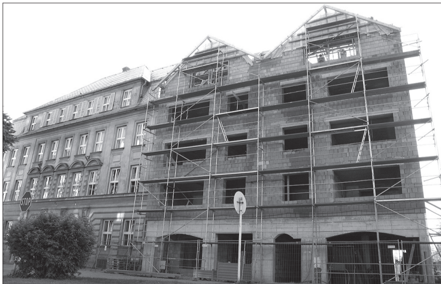
Przy placu Wolności w Starym Boguminie rosną nowe domy mieszkalne. Właśnie zakończono podłączanie ich do sieci elektrycznej, wodociągowej i kanalizacyjnej. Na finiszu są też prace przy kotłowniach gazowych.
