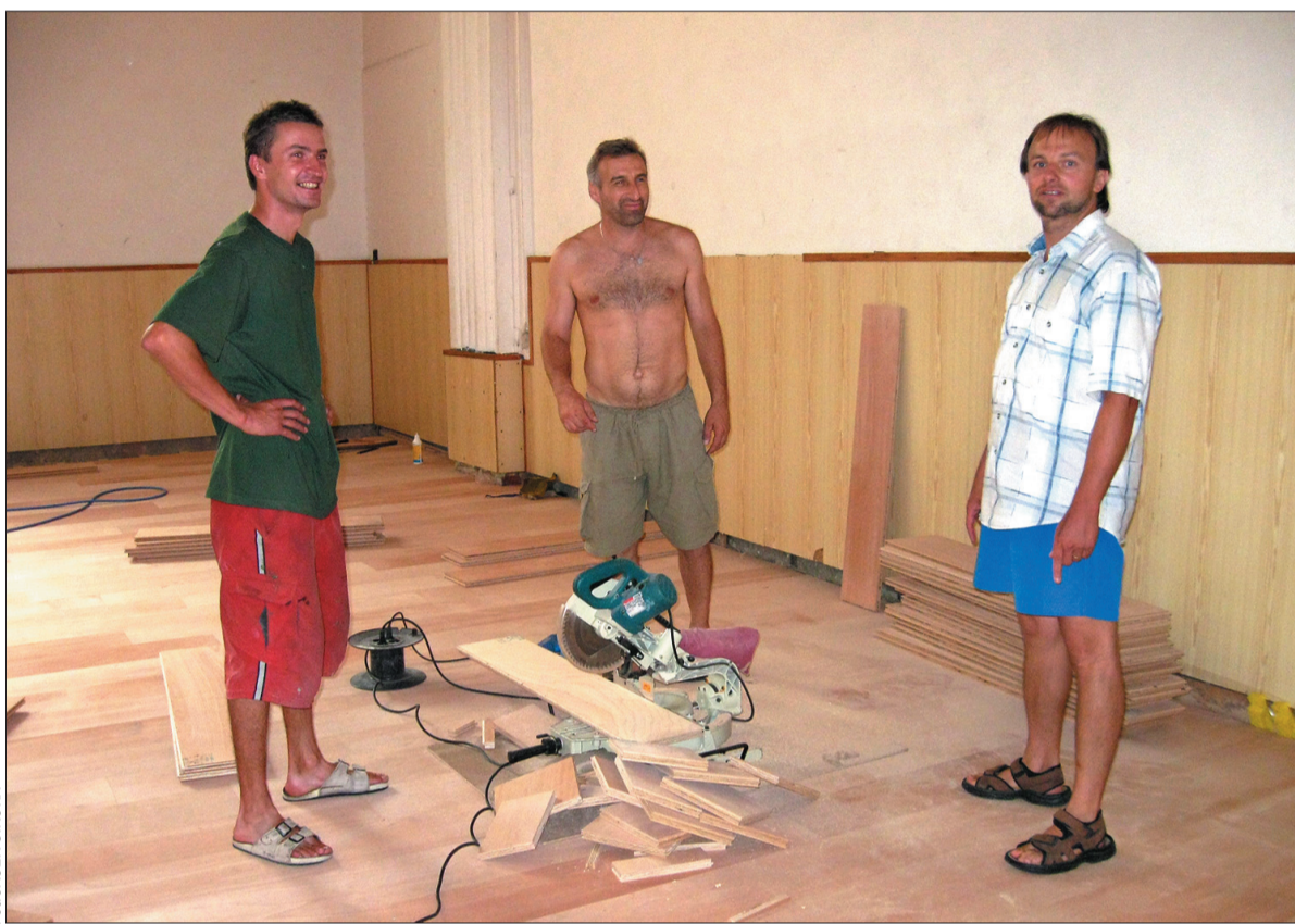
Dyrektor czeskocieszyńskiej PSP, Marek Grycz (z prawej), osobiście dogląda remontu sali gimnastycznej.
